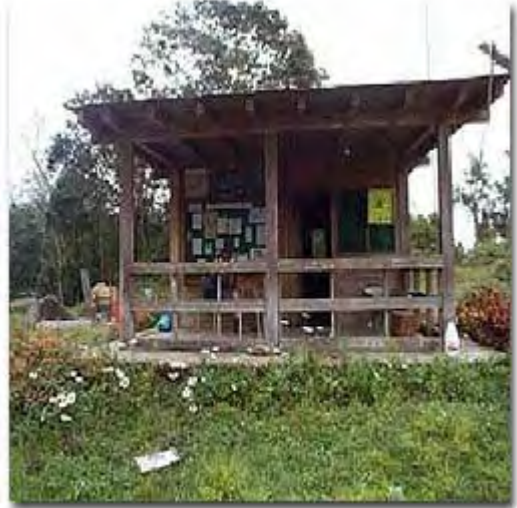
La antigua estación de guardaparques en El Blanquito aún permanece en pésimas condiciones (Foto: César Aponte de la primera visita en 2001)
